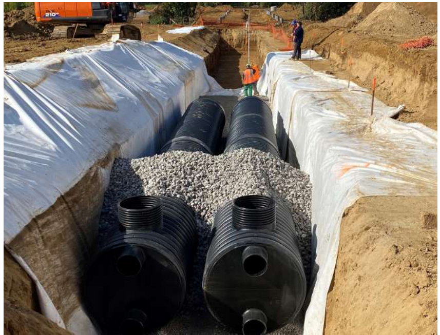
Bassin de tamponnement / infiltrant réalisé Par Polieco avec un tube SN8, ID 1200 mm.
