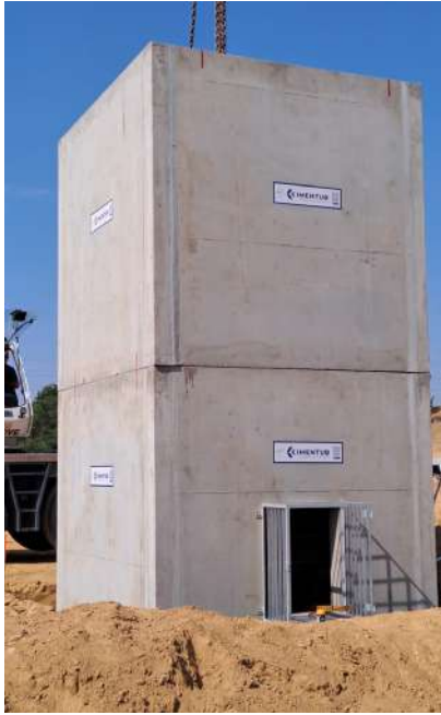
Sur le chantier de la RD52, Cimentub a réalisé un ouvrage permettant la régulation des eaux du bassin versant en sortie de bassin à ciel ouvert.
