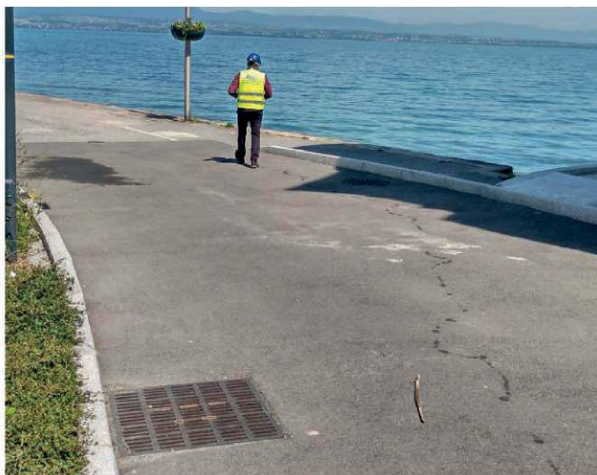
Funke a installé des avaloirs épuratoires Innolet à Publier (Haute-Savoie) pour traiter les eaux ruisselant sur la voirie, et les rejeter propres dans le lac Léman.
