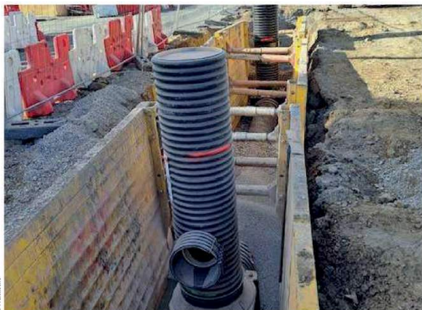
Chez Fränkische, un substrat adsorbant peut compléter l'action de solutions de sédimentation comme ce Sedipe installé à Port-la-Nouvelle (Aude).
